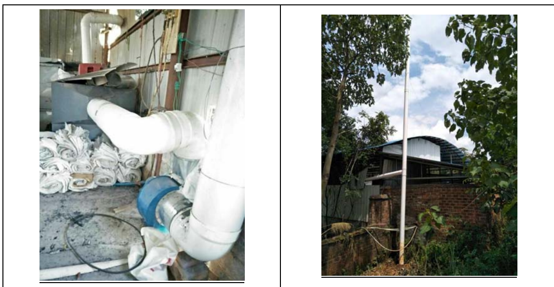
图 5-2 现有活性炭装置及排气筒
